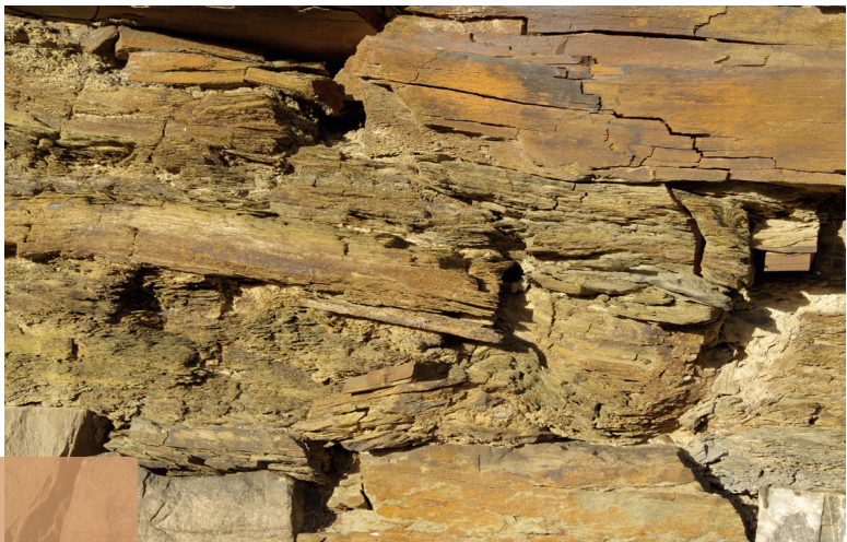
Abbildung 31: Verwitterung von Mauer- steinen (Schiefer)
